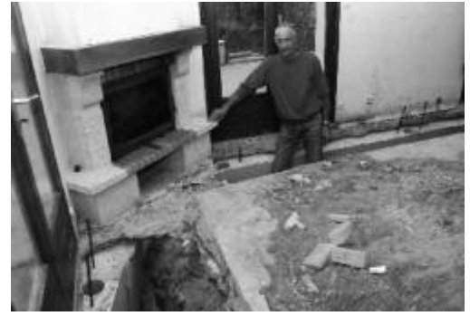
La pose de micro-pieux par l'intérieur de la maison a été rendue nécessaire. L'aboutissement de deux ans de démarches PHOTO STEPHANE PAPEAU
